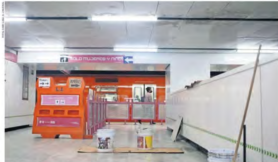
Las filtraciones se presentan en estaciones como Sevilla, Merced y Salto del Agua; el problema se origina en las jardineras del exterior, dijo el STC.
