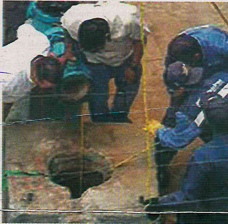
En 12 pozos se detectó que el agua tiene condiciones óptimas
