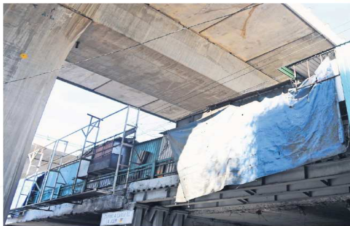
El puente vehicular que se ubica en el límite entre la Ciudad y el Estado de México registra una sobrecarga por la cantidad de puestos ambulantes y anuncios espectaculares.
