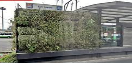
■ Todavía en agosto de 2019, la CDMX emitió una invitación restringida para dar mantenimiento a los muros.
