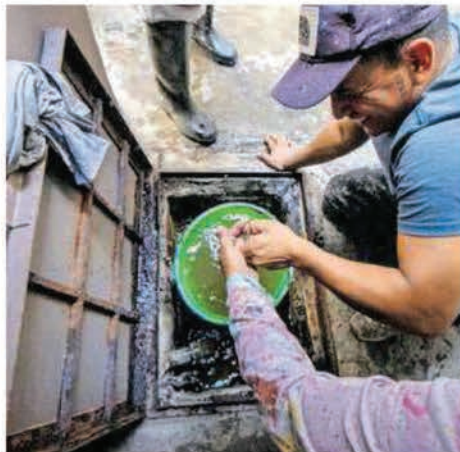
En la desinfección se utiliza cloro
