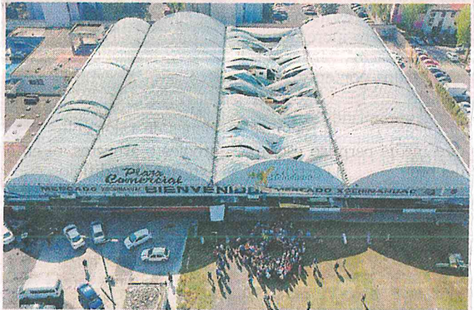
La techumbre del Mercado de San Martín Xochinahuac, en Azcapotzalco, fue dañada por el granizo del viernes.
