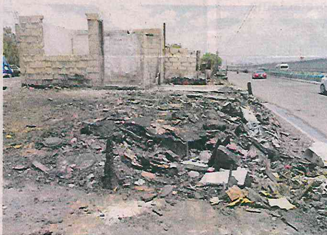
■ En el lugar del incendio en el Municipio de Neza permanecen bloques y láminas quemadas.
