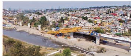
En la presa de Tacubaya, la estructura que colapsó el mes pasado no ha sido retirada.
