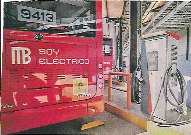
En el patio de mantenimiento de la Línea 3 es construida la red de recarga eléctrica de las unidades.
