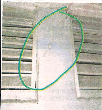
Reportan que las nuevas instalaciones tienen problemas estructurales
